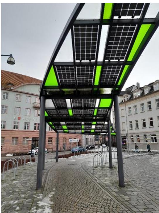
Abbildung 4: Mit Photovoltaikmodulen bestückte Überdachung am Klimaparkplatz
